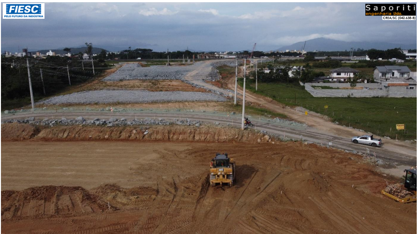
28: PASSAGEM INFERIOR NO KM 231+900 – Região de solos moles, onde foram utilizados drenos verticais a cada 1,5 metros e, posteriormente, aterro com sobre carga para adensamento
