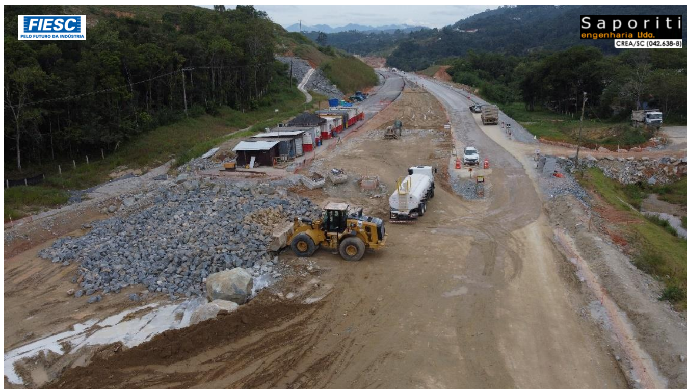
22: OBRAS DE IMPLANTAÇÃO E PAVIMENTAÇÃO NO KM 227 – Estima-se em 20% as obras remanescentes no segmento entre os kms 227 (Túnel 03) e 229 (BR-282)
