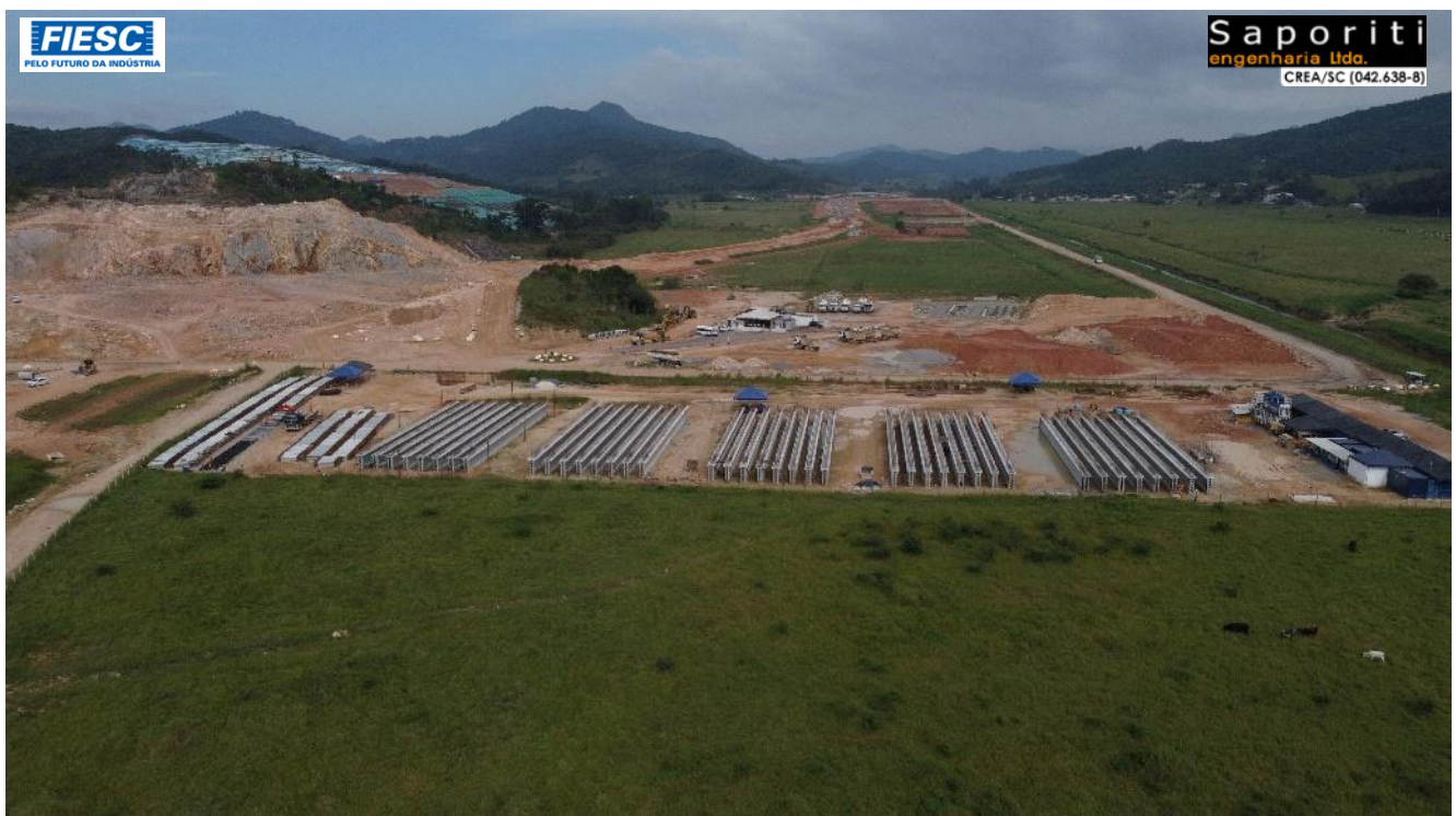
2: VIGAS LONGARINAS FABRICADAS, a serem lançadas nos viadutos em execuções no segmento do Trevo Norte
