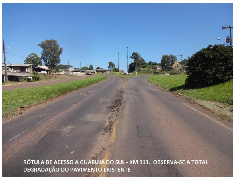
SITUAÇÃO DEPLORÁVEL DO PAVIMENTO NO KM 110
