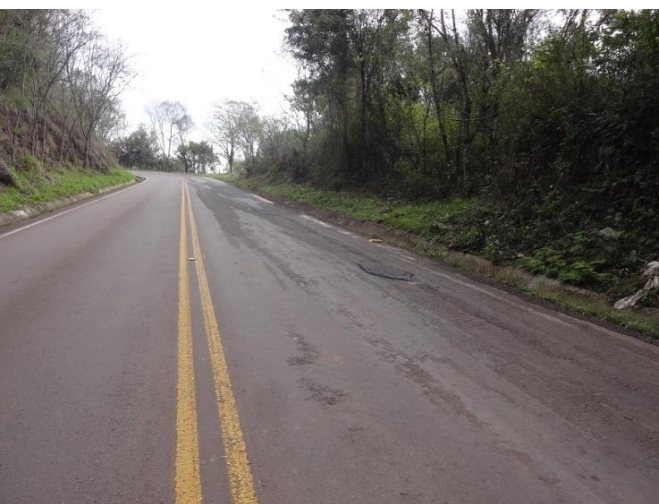
Km 31 - Anchieta/ Campo Erê - Desagregação do pavimento
