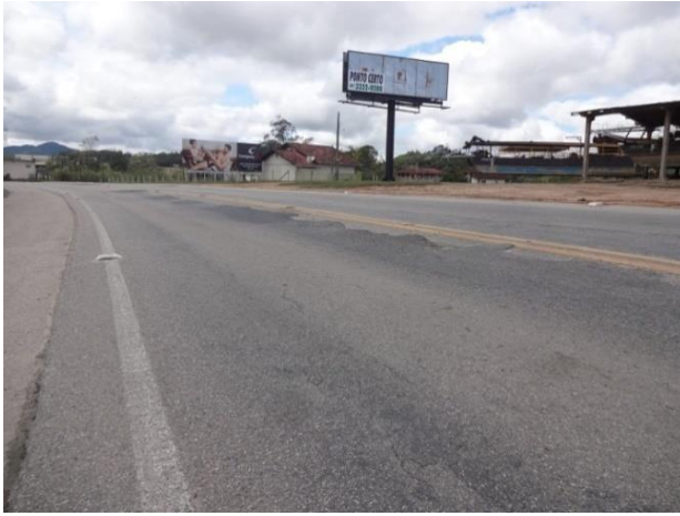
Km 20,2 - Operação "tapa buraco" sobre pavimento afundando
