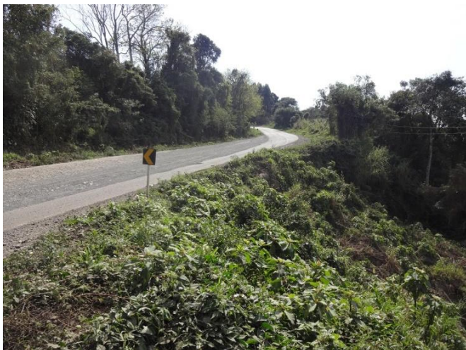
Escorregamento no km 105
