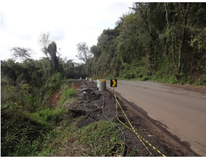
Deslizamento parcial de pista- Águas de Chapecó
