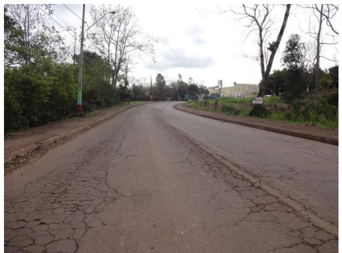
Mondáí- Rio das Antas- Trilha de roda, trincamento e desagregação do pavimento
