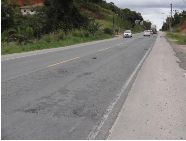
Km 105 - Afundamentos, recalques e desagregação do pavimento
