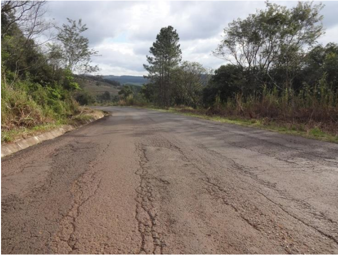
Situação do pavimento no km 14,5
