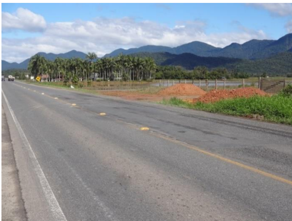
Trecho Joinville/Guaramirim - km 8 - Buracos e afundamento do pavimento
