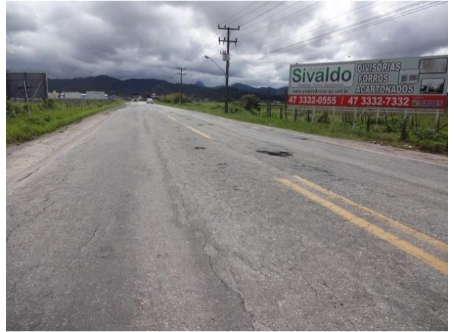
Contorno de Gaspar- km 27- Situação pavimento
