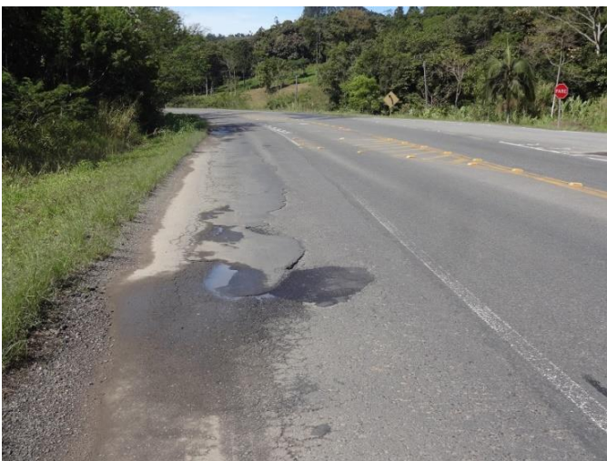
Km 24,5 - Deterioração do pavimento.
