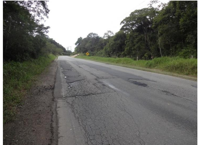
Km 74,5 - Buracos e deformações do pavimento
