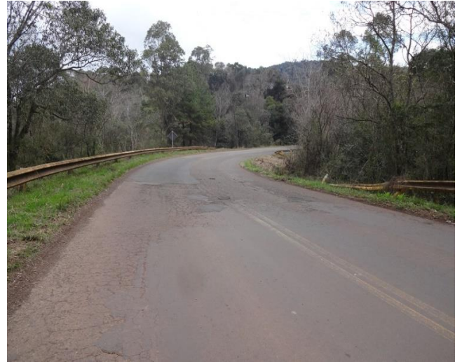
Desagregação e trincamento no km 11,2
