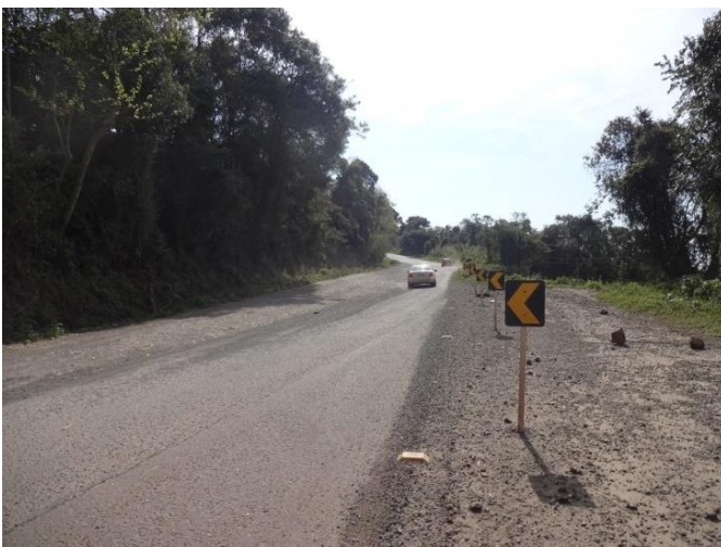
Escorregamento de pista no km 51,7
