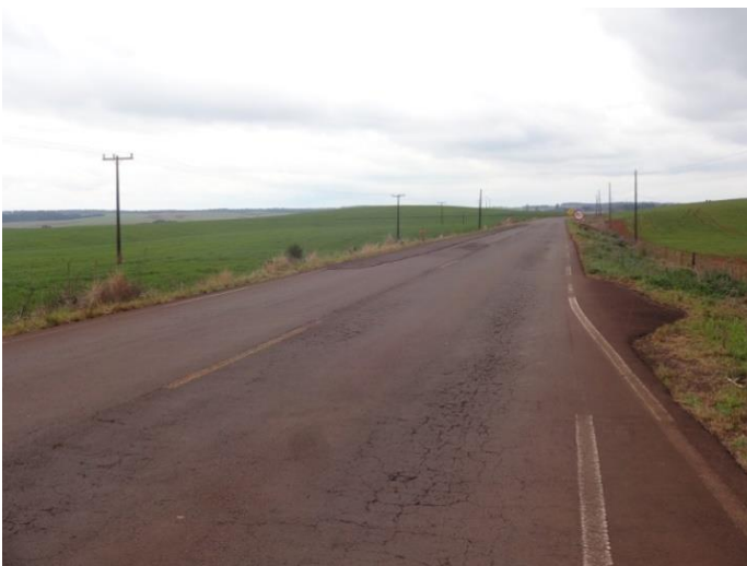
Trecho Palma Sola/ Anchieta - km 14 - Situação do pavimento
