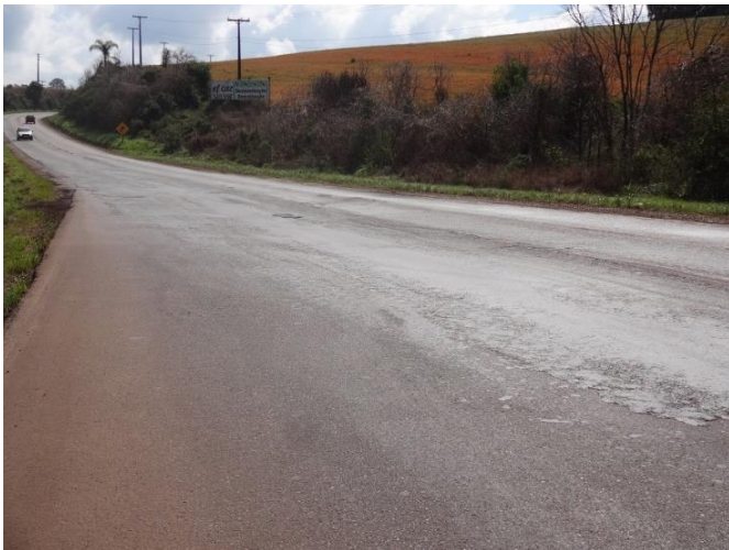
Km 82,5 - Trilha de roda e afundamento do pavimento
