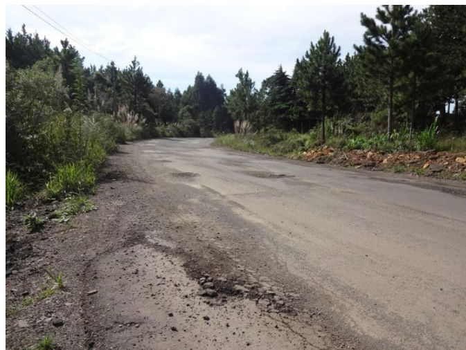
Km 21,5 – Afundamentos e recalques na pista
