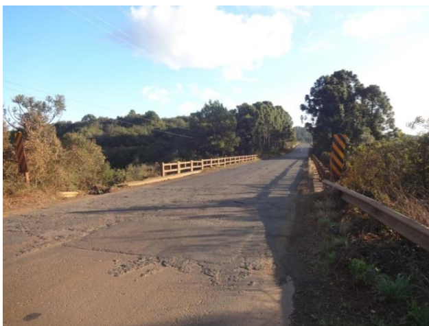
Km 11,80 - Situação da Ponte e do pavimento
