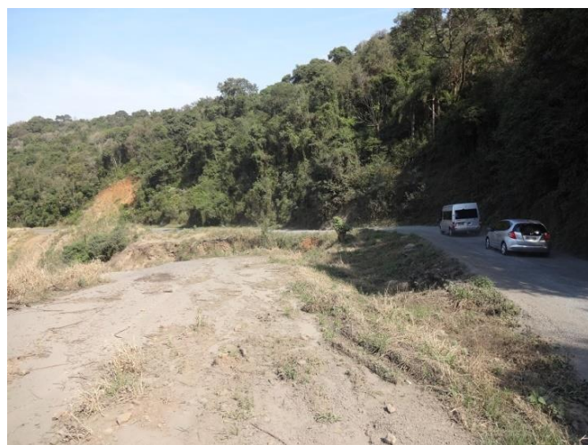
Km 70 - Deslizamento de toda a pista
