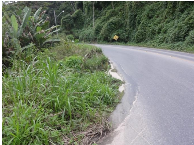
Deslizamento na Serra – km 97,5
