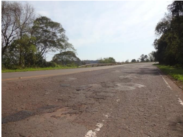
Km 32, entre Acesso de Itá e Seara – Desagregação do pavimento
