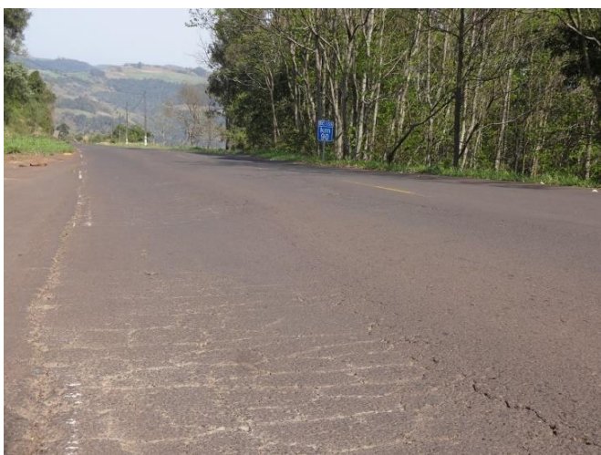
Trincamento e desagregação do pavimento - km 90
