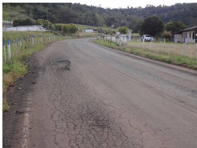
Km 102,8 - Buracos e deformações do pavimento
