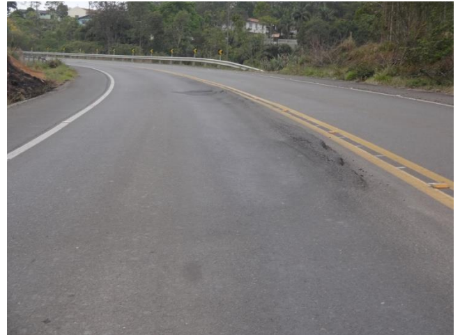
Trecho Lauro Muller/ Treviso- km 5,4- Afundamento do pavimento
