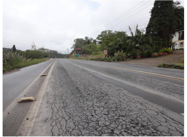
Situação do trincamento geral do pavimento- km 346
