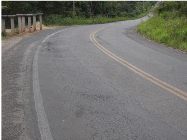
Contorno de Orleans - km 438,5 - Trincamento do pavimento
