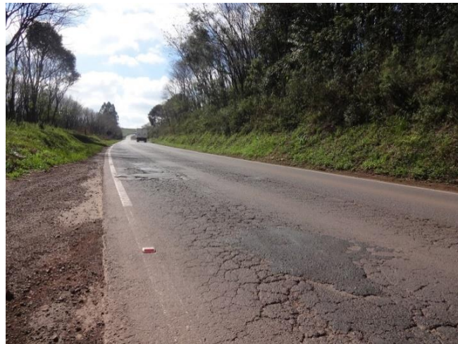
Contorno de Xanxerê- km 94- Situação pavimento
