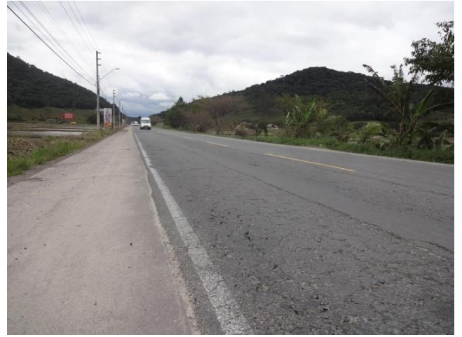
Km 104- Trincamento do pavimento
