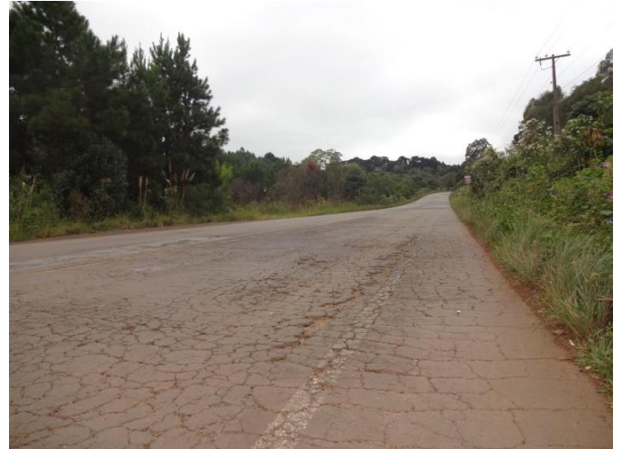
Segmento entre Taquara Verde/ BR-153 – km 163,7 - Trincamento
