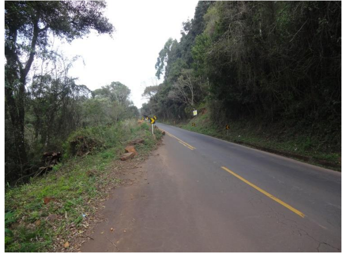
km 59,5 - Escorregamento parcial da pista
