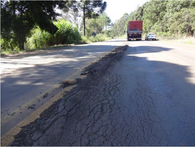
Km 178 – Afundamentos e recalques da pista
