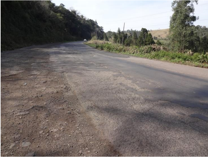
Situação do pavimento no km 27
