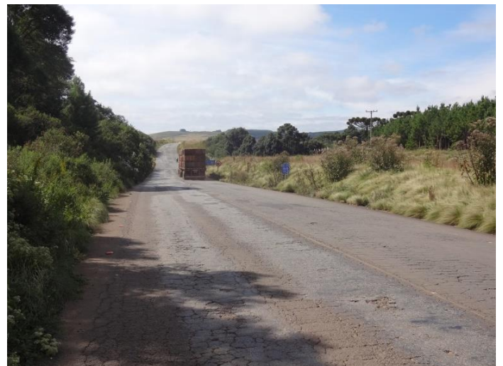
Km 116 – Desagregação do pavimento
