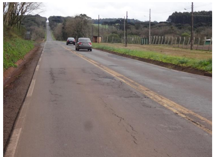
Trecho Chapecó/ Planalto Alegre- Trincamento e desagregação do pavimento
