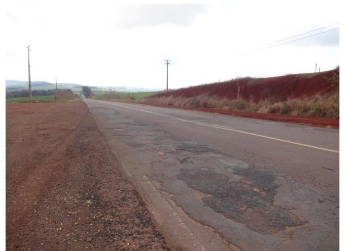
Trecho Bom Jesus/ Xanxerê - km 80 - Situação pavimento
