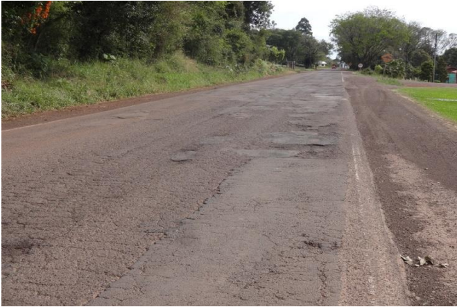
Buracos e deformações graves no km 97
