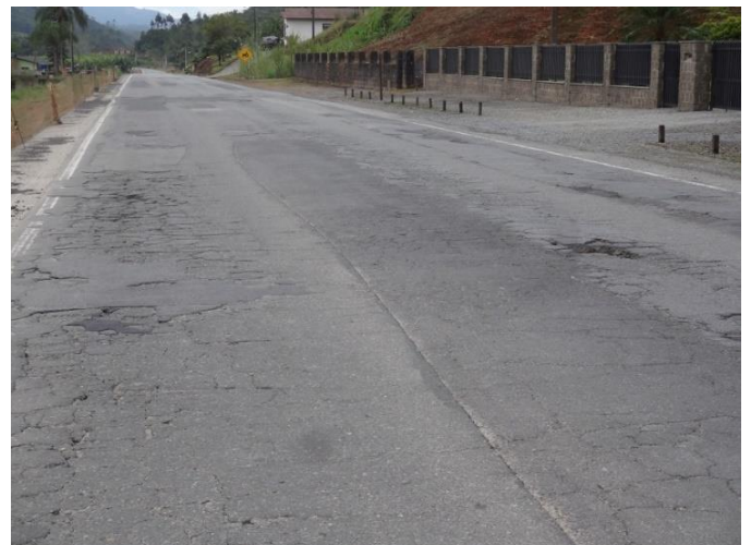
Situação do pavimento no km 91,5
