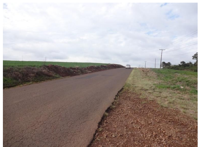
Km 26,5 - Trincamento da capa asfáltica
