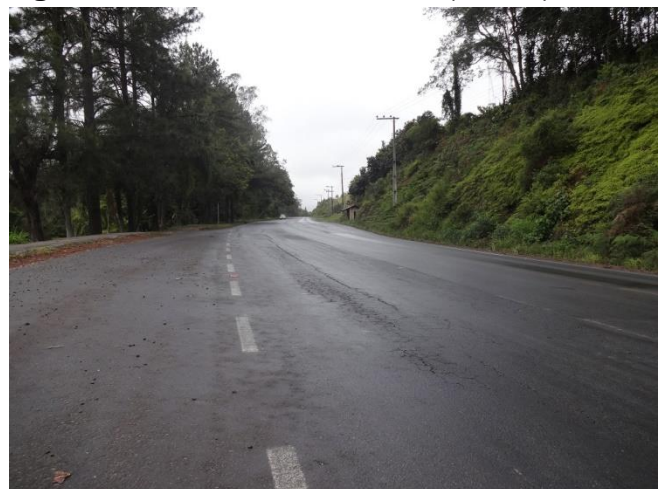
Km 349,5 - Pavimento trincando
