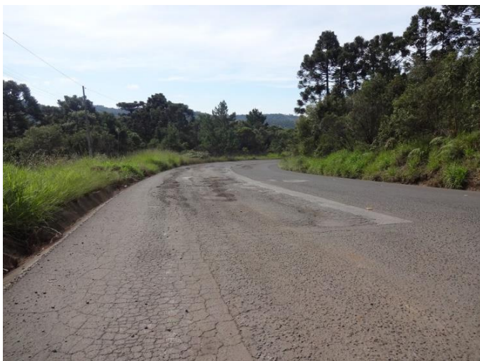
Km 12,8 – Buracos e afundamento do pavimento
