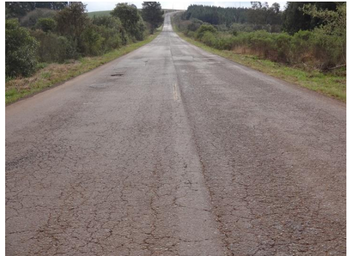
Km 6,8- Deterioração do pavimento
