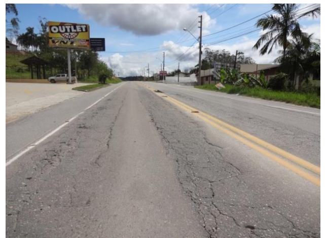
Trecho Gaspar/ Brusque - km 109,5 - Desagregação do pavimento
