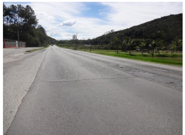
Trecho Guaramirim/ Massaranduba - km 39,5 - Situação pavimento
