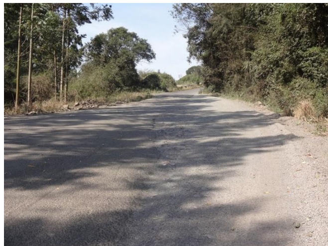
Escorregamento da pista- km 80,5
