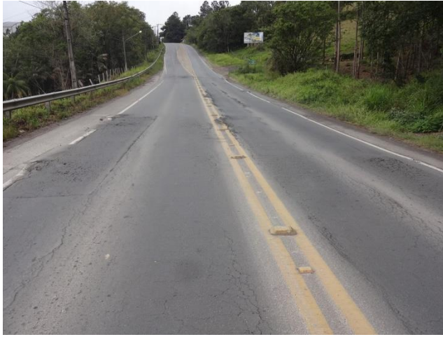
Km 347,5 - Pavimento se deteriorando
