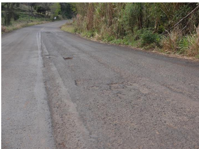
Buracos, afundamentos e recalques do pavimento - km 86
