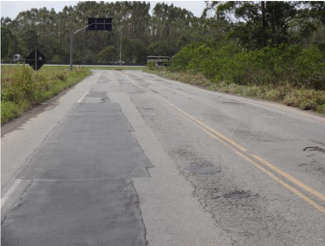
Situação do pavimento no entroncamento c/ BR-101
