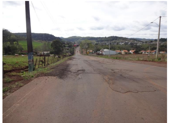
Trecho Riqueza/ Mondáí - km 179,5- Buracos e afundamentos
