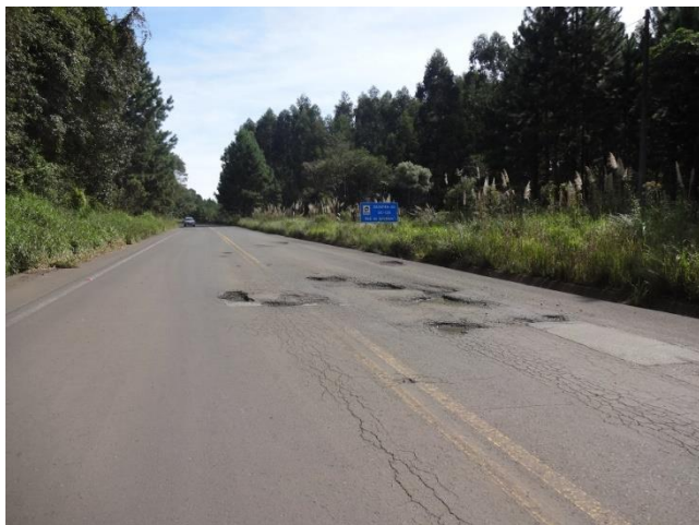
Figura 26: km 20,6 - Situação da pista
