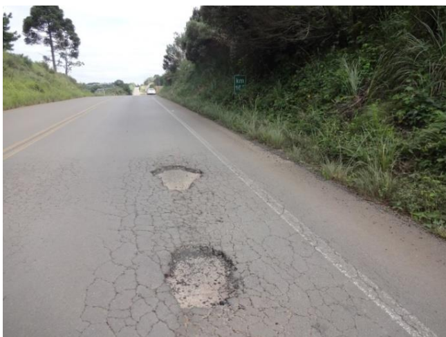
Figura 14: km 154 - Buracos e trincamento pavimento
