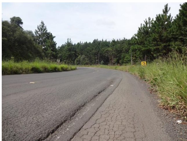
Figura 22: km 8,5 – Trilha de roda, trincamento e desagregação do pavimento
