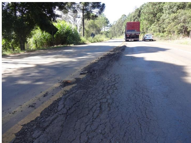
Figura 3: Afundamentos recalques da pista - Km 178
