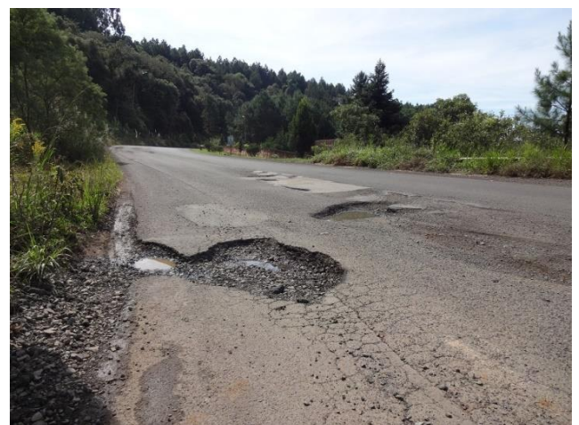
Figura 25: Inúmeros buracos na pista no km 16,5
