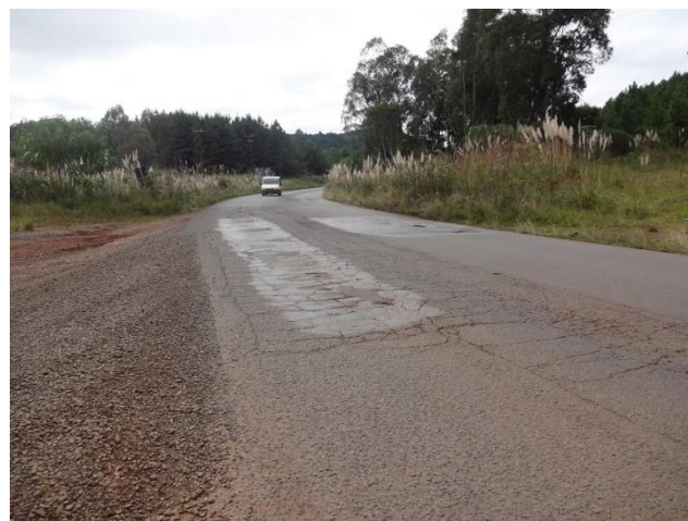
Figura 15: km 133 - Trilha de roda, trincamento e desagregação
