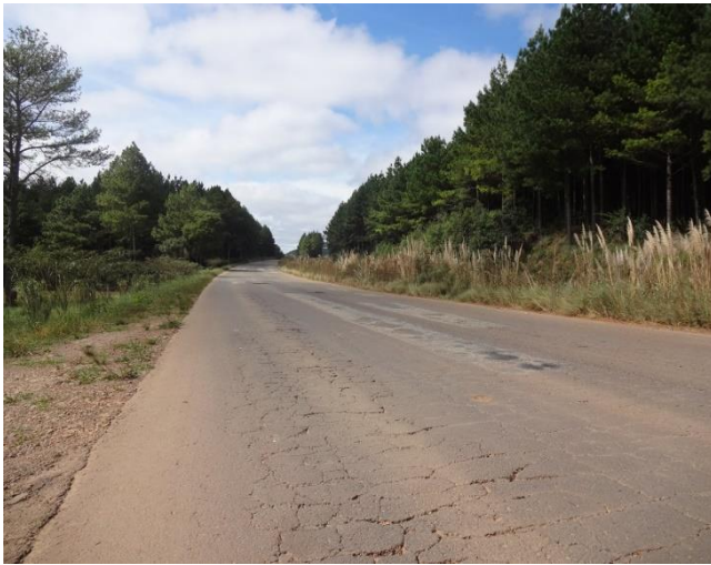
Figura 16: km 129,5 - Trincamento do pavimento
