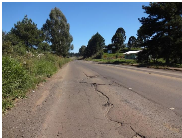
Figura 4: Situação do pavimento no km 185,20
