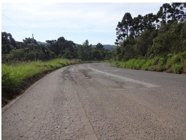
Figura 24: km 12,8 - Buracos e afundamento pavimento
