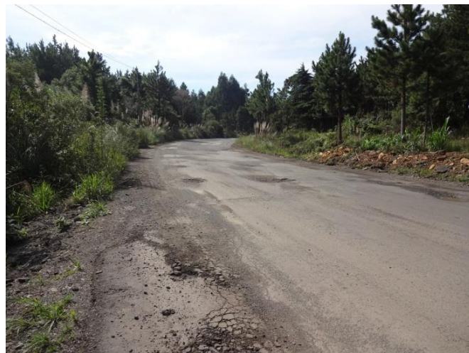
Figura 27: km 21,5 - Afundamentos e recalques na pista
