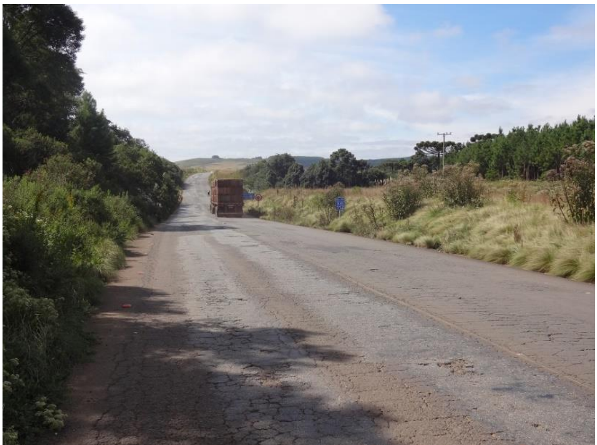
Figura 18: Desagregação do pavimento - km 116
