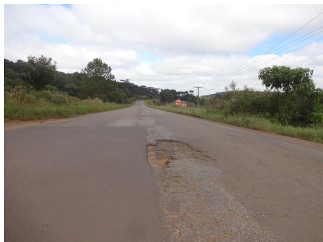
Figura 13: km 160,2 - Situação do pavimento
