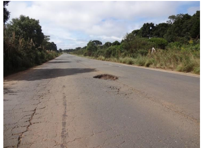
Figura 17: Segmento c/ 5 km - muitos buracos (km 117,5)
