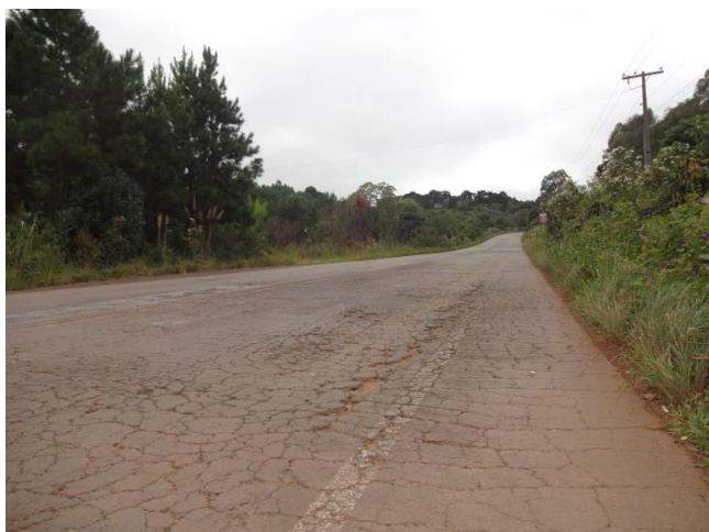
Figura 12: km 163,7 - Trincamento do pavimento
