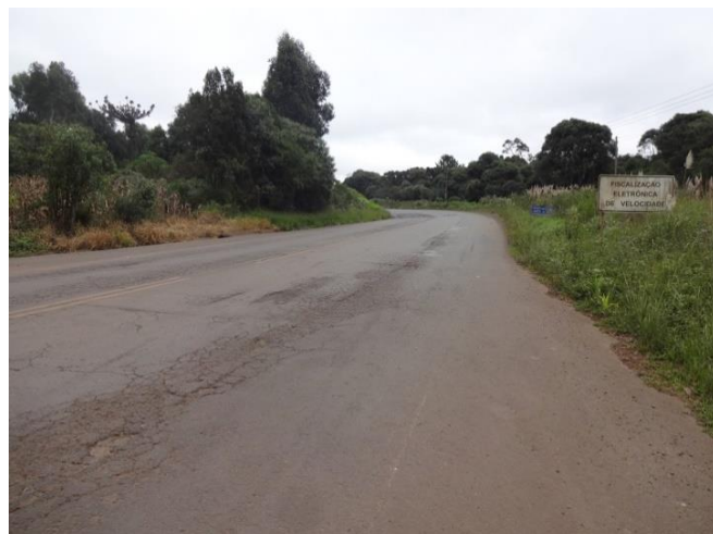
Figura 11: Trincamento e desagregação do pavimento - km 171
