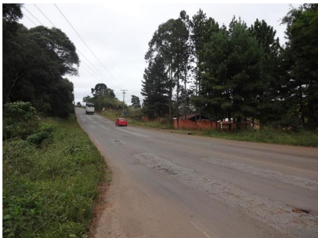
Figura 10: km 175 - Recalques e buracos no pavimento
