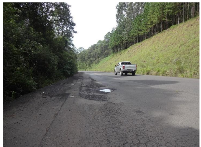
Figura 23: km 11,3 - Situação do pavimento
