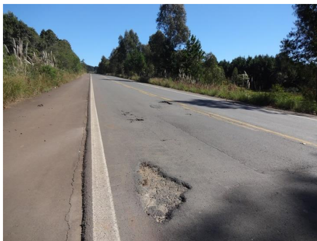
Figura 7: Buracos, afundamentos e recalques no pavimento km 223
